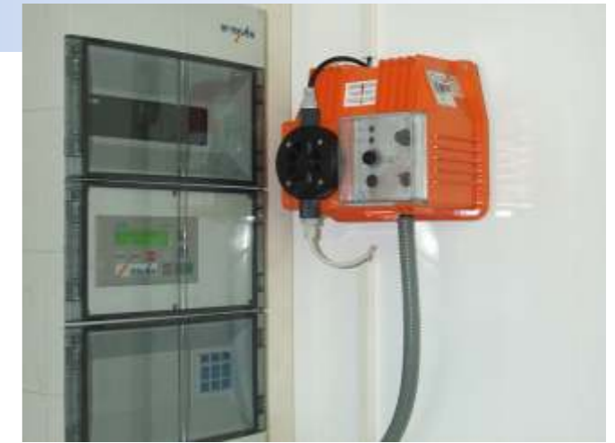
Schaltschrank mit Dosierpumpe
